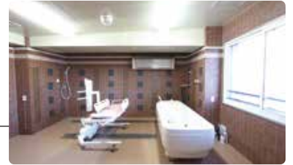
特別介護浴室 寝たきりの方専用の 介護浴槽を設置して おります。
